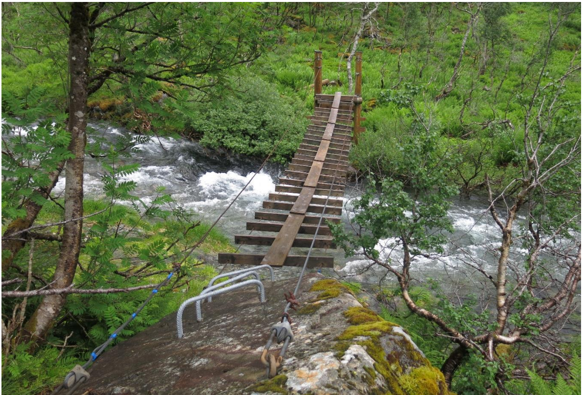
Bilete 6. Hengebrua over elva ved Grøndalsstøylen. Her er det behov for opprusting om stien skal ha den standrarden vi vil at den skal ha.
