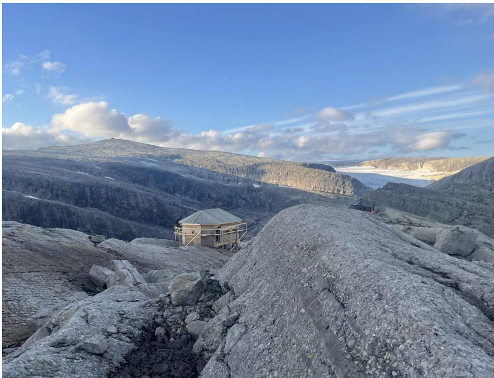
Bilete 3 og 4. Den nye sikringshytta ved Gjegnabu under oppføring. På bilete 4 kan du sjå Gjegnabu i bakgrunnen til høgre, og Gjegnen i bakgrunnen til venstre. Foto: Dag Eliassen
