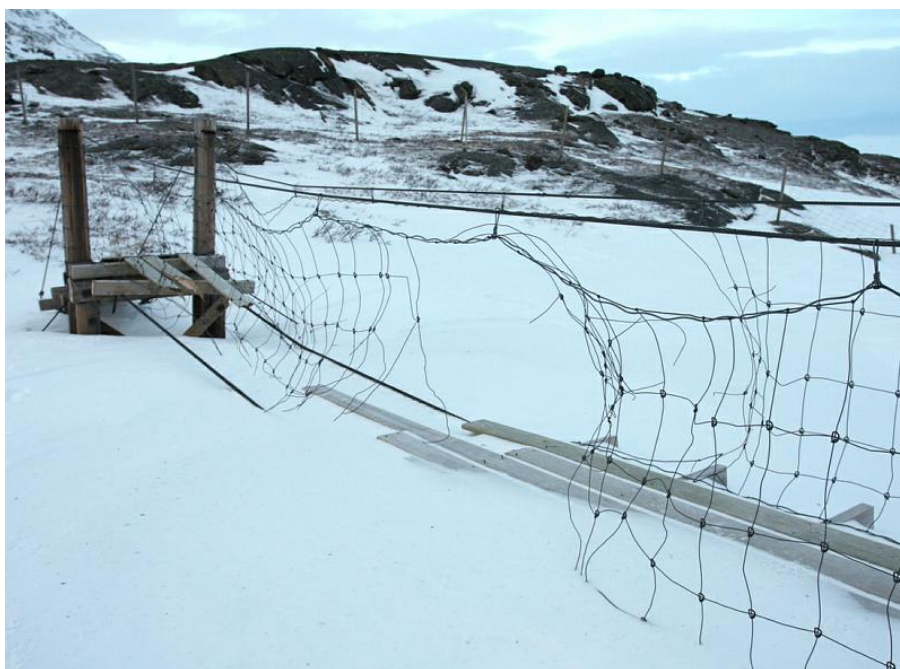
Ødelagt hengebru ved Skaitikjeften vinteren 2011. Foto: Jim Tovås Kristensen
