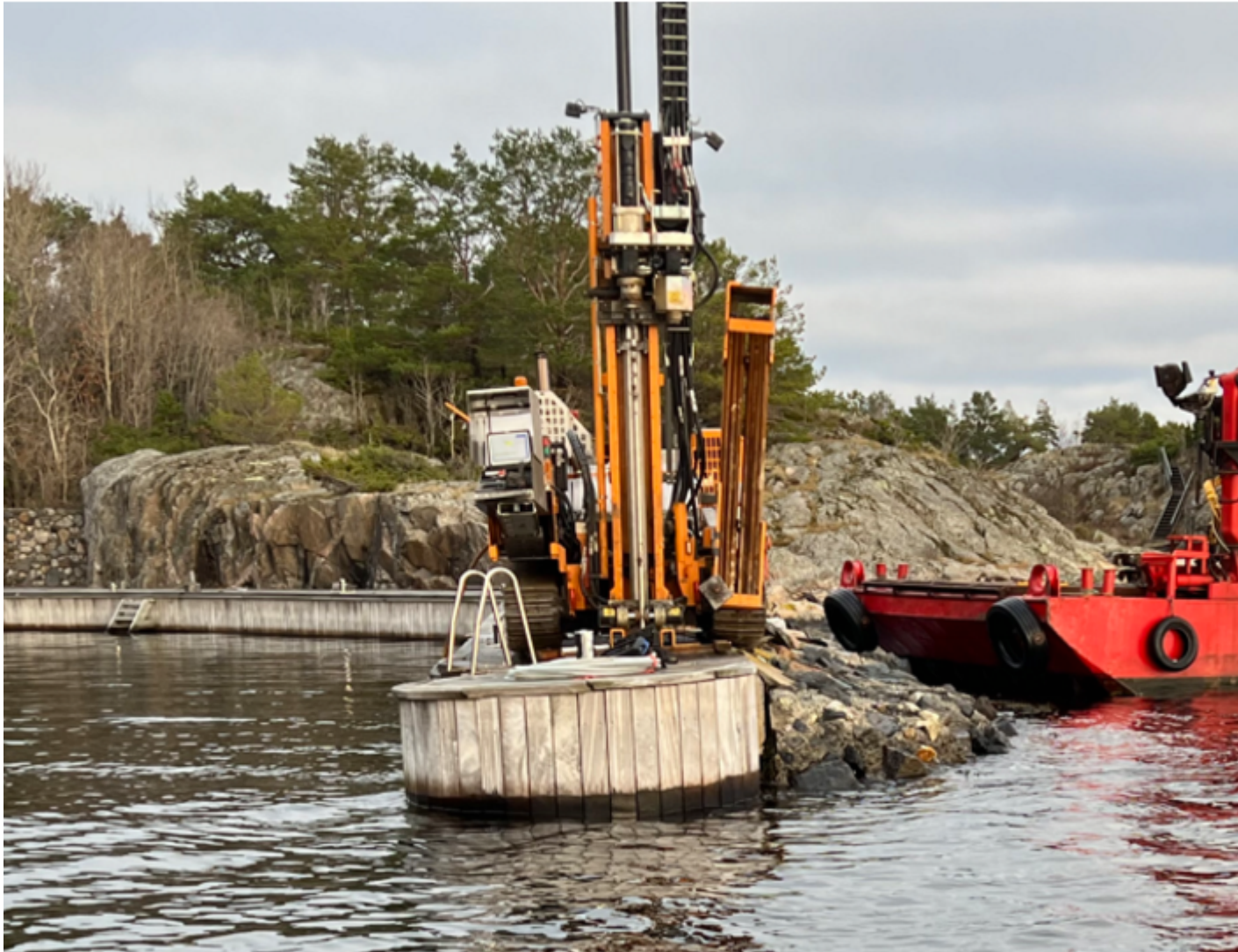
Figur 4 - Bilde fra våren 2023 som viser at moloen er i ferd med å deformere seg innover i båthavna. Bilde tatt ifbm. grunnboringer.
