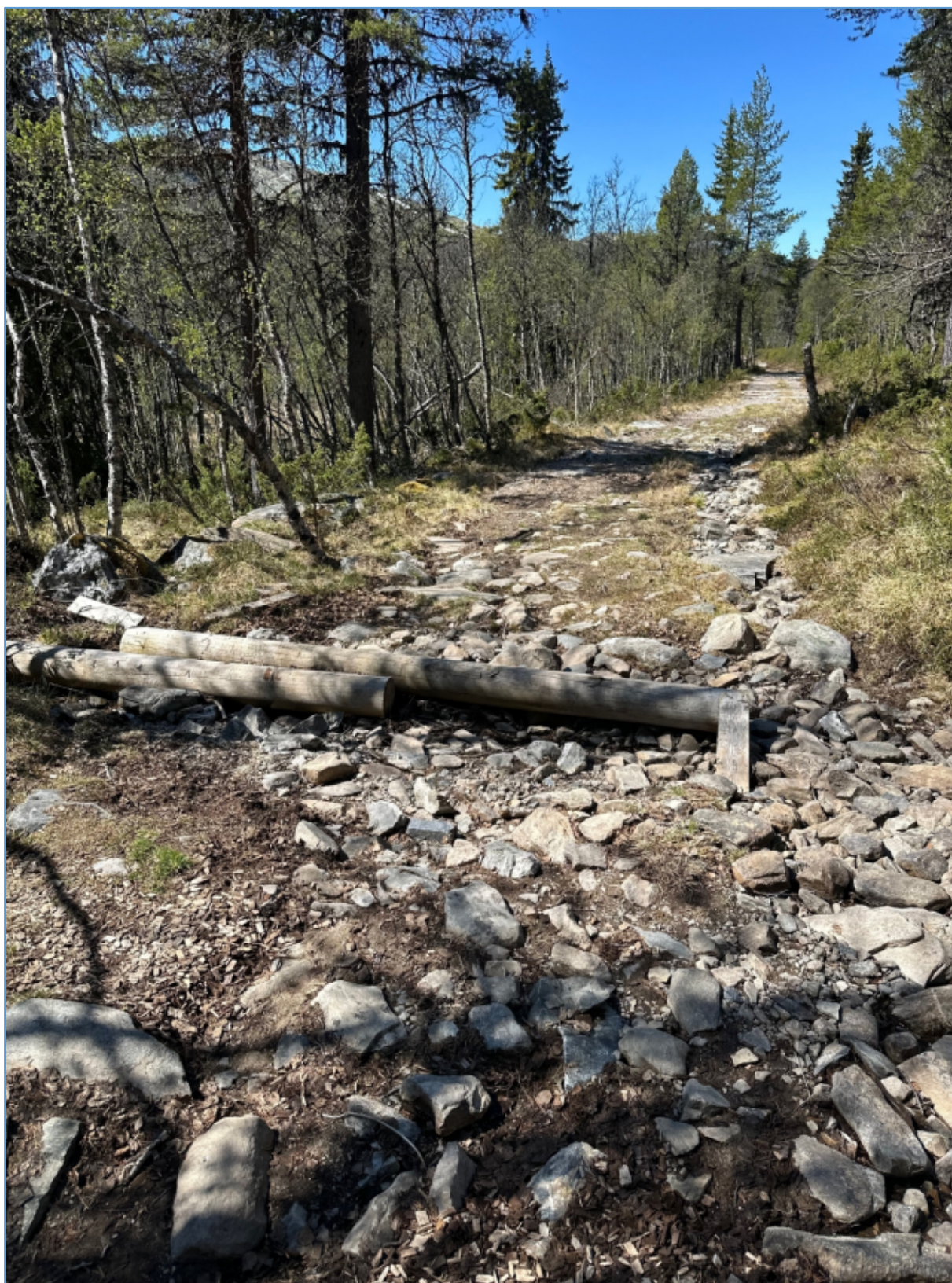
Figur 4. Skade på sykkelsti «Pungentraseen», vedlegg til søknad fra Rondane Kvamsfjellet Turløypelag.
