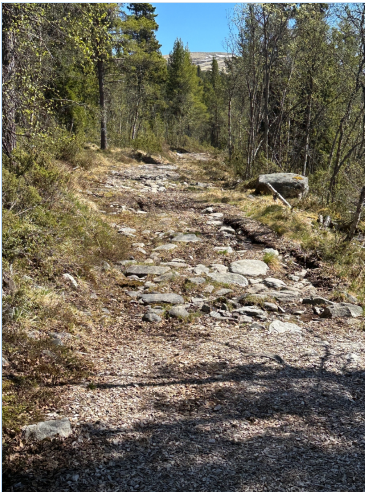
Figur 2. Skade på sykkelsti «Pungentraseen», vedlegg til søknad fra Rondane Kvamsfjellet Turløypelag.
