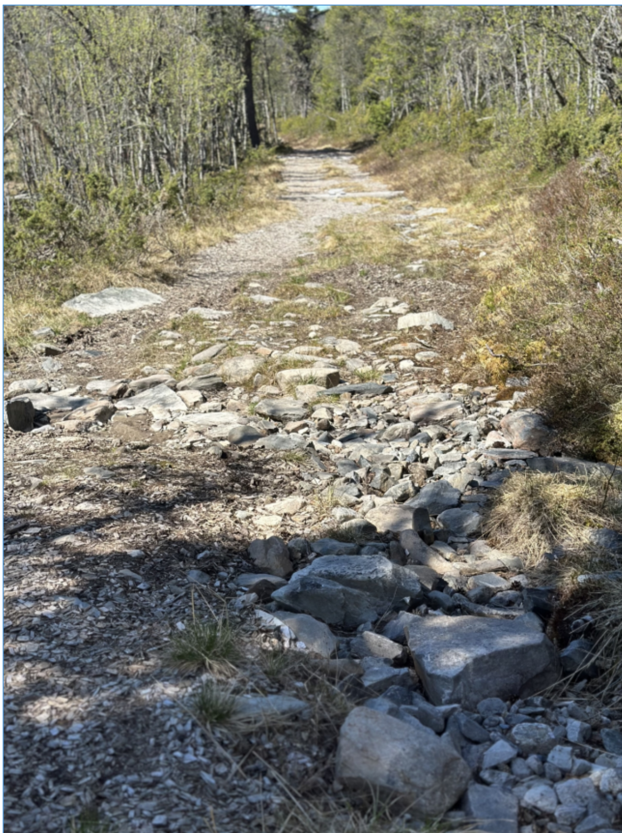
Figur 5. Skade på sykkelsti «Pungentraseen», vedlegg til søknad fra Rondane Kvamsfjellet Turløypelag.
