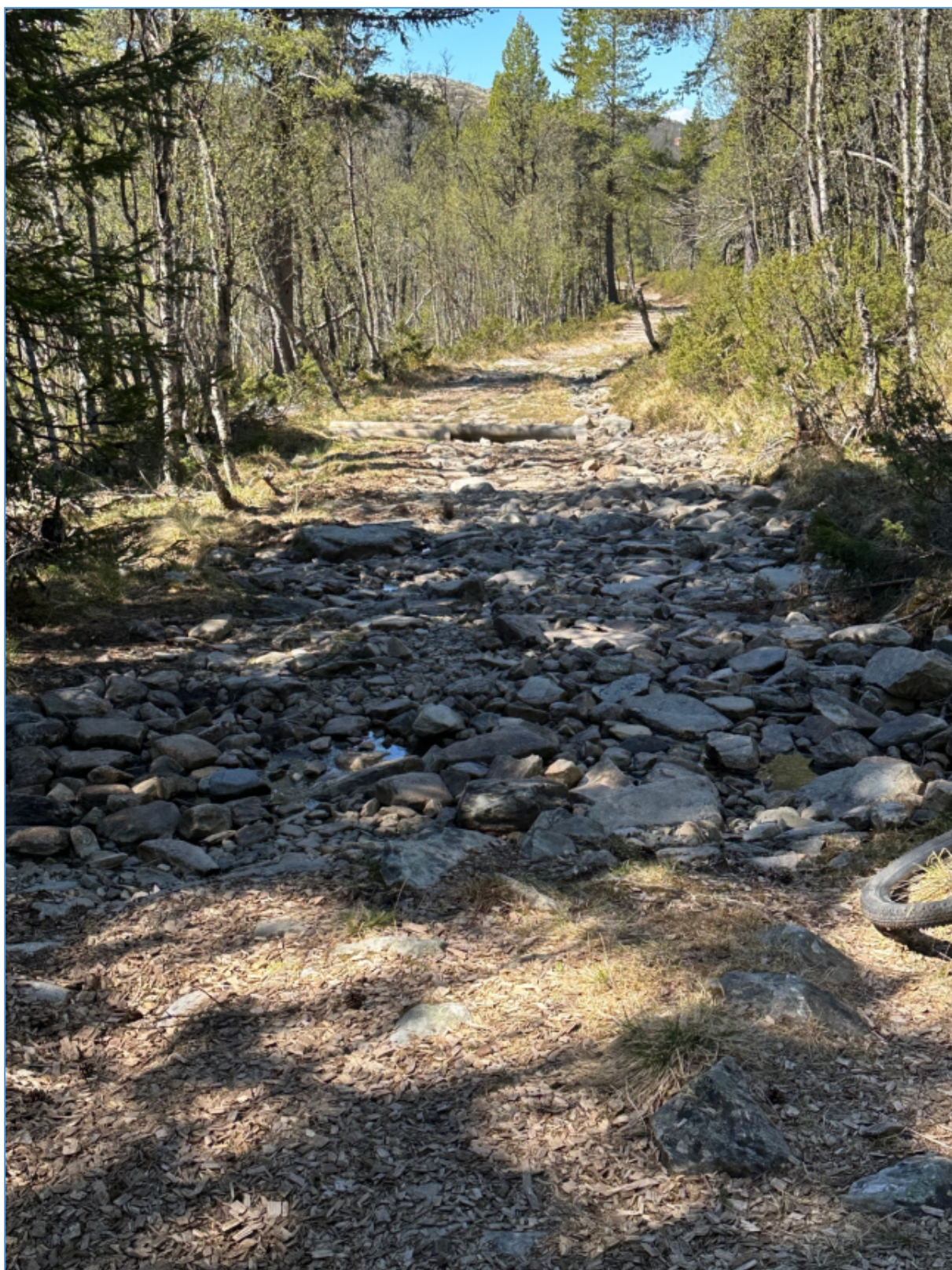
Figur 3. Skade på sykkelsti «Pungentraseen». I forgrunnen rester av hoggerflis, som ble lagt ut etter råd fra Fylkesmannen i Oppland i 2011. Vedlegg til søknad fra Rondane Kvamsfjellet Turløypelag.
