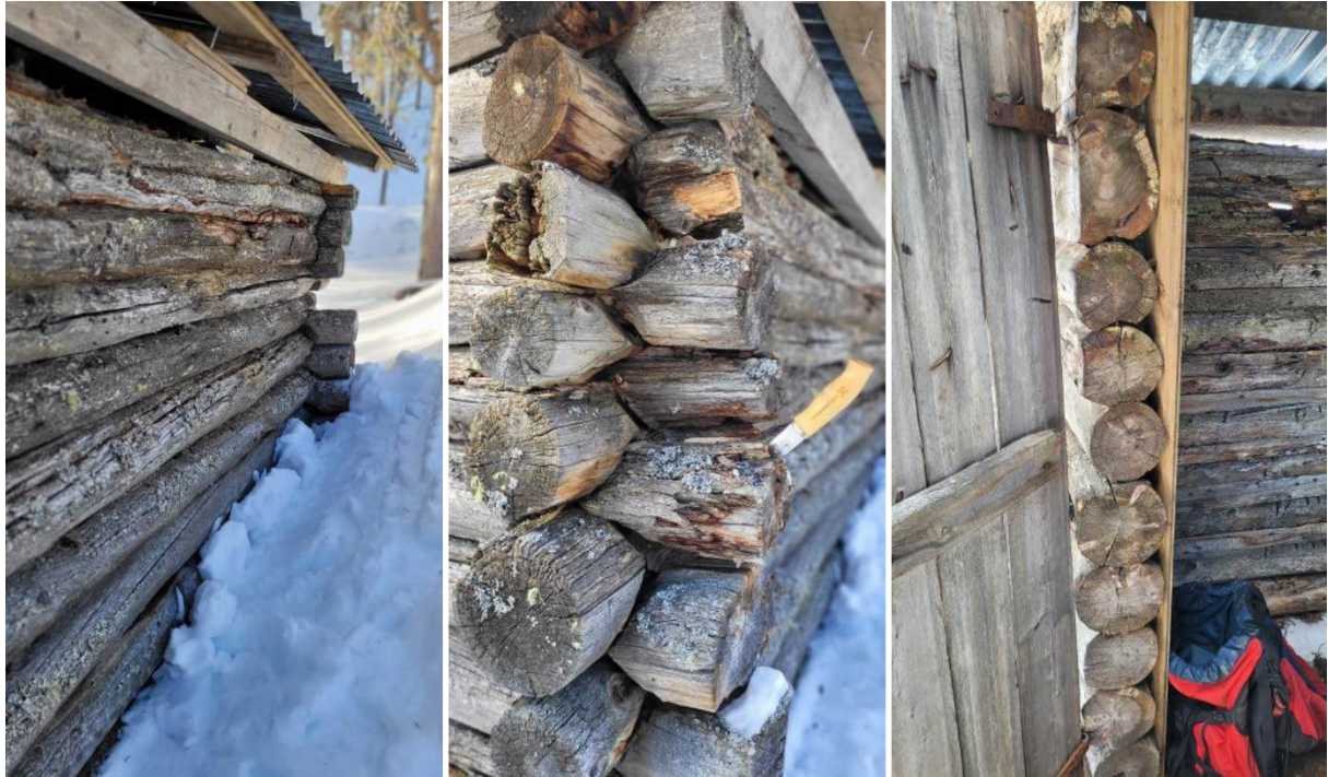
Nr 1 og 2 NV langvegg, mest råte. Nr 3. Enkel dørøpning.
